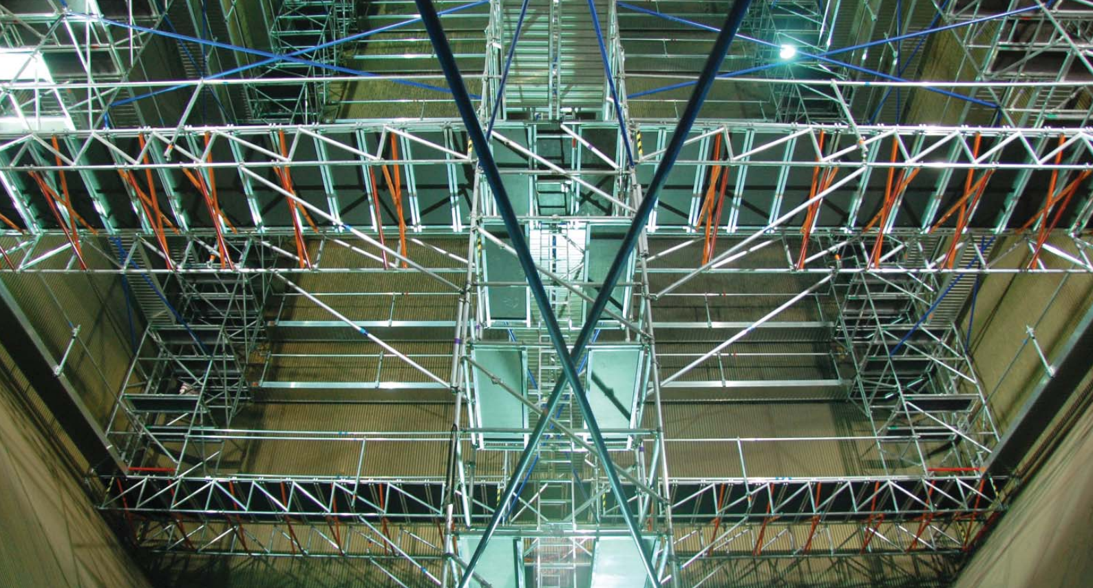
Вверху: Система доступа к котлу, Manjung, Малайзия Установка на 660 МВт, поставленная в ноябре 2007 г. Вид снизу от желоба, показывающий фермы основания и верхнюю конструкцию.
