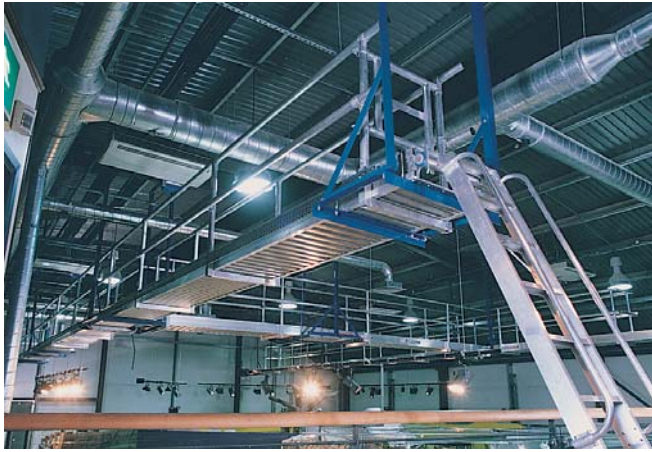
La instalación permanente de una pasarela Spandek suspendida en el Royal Signals Museum permite acceder a distintas áreas de trabajo de la cubierta, como el sistema de refrigeración, sin necesidad de cerrar al público la exposición.
